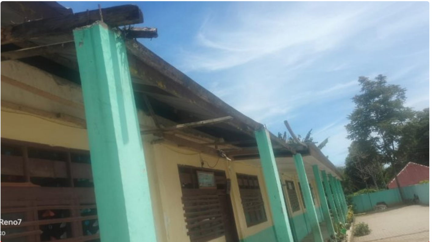
Perbaikan Teras SD Inpres Lingga, Kecamatan Simpang Empat, Kabupaten Karo yang mangkrak
